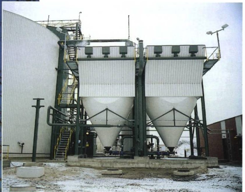
Anaerobanlage Werk Brottewitz
