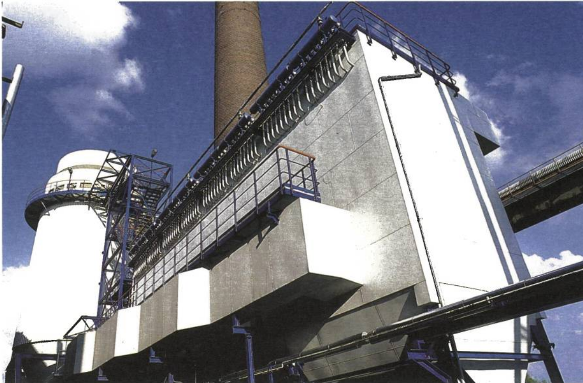
Delitzsch: Rauchgas- entschwefelungs- anlage.
